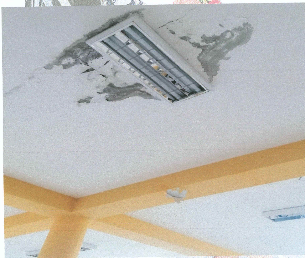
Figura 1. Se aprecia la filtración de agua en los ambientes.
