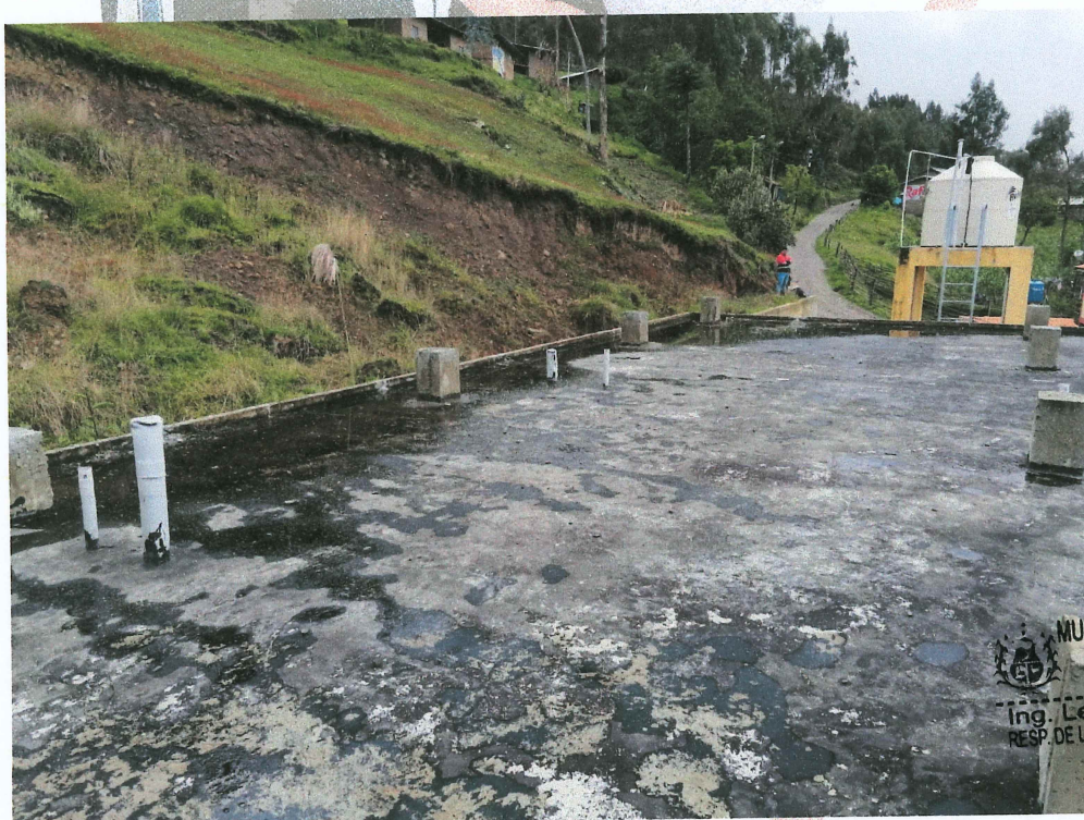
Figura 3. Se aprecia la acumulación de agua en el techo del puesto de salud de Orogolday.
