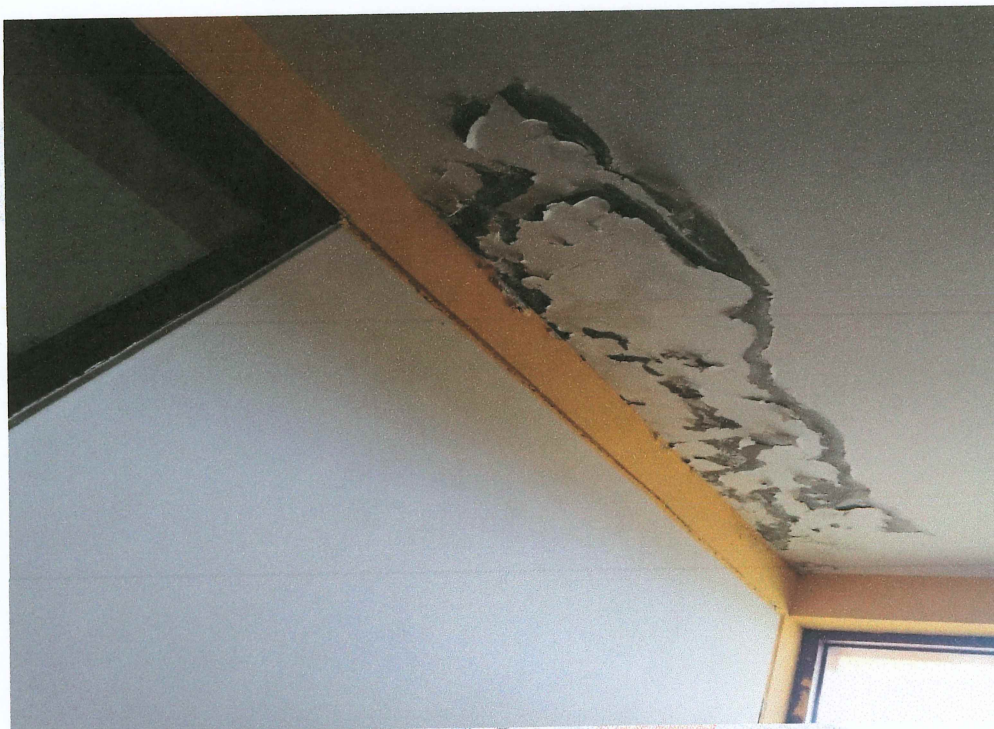
Figura 2. Se aprecia la filtración de agua en los ambientes.
