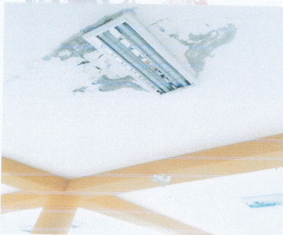
Figura 1. Se aprecia el desprendimiento de la pintura en el techo.
