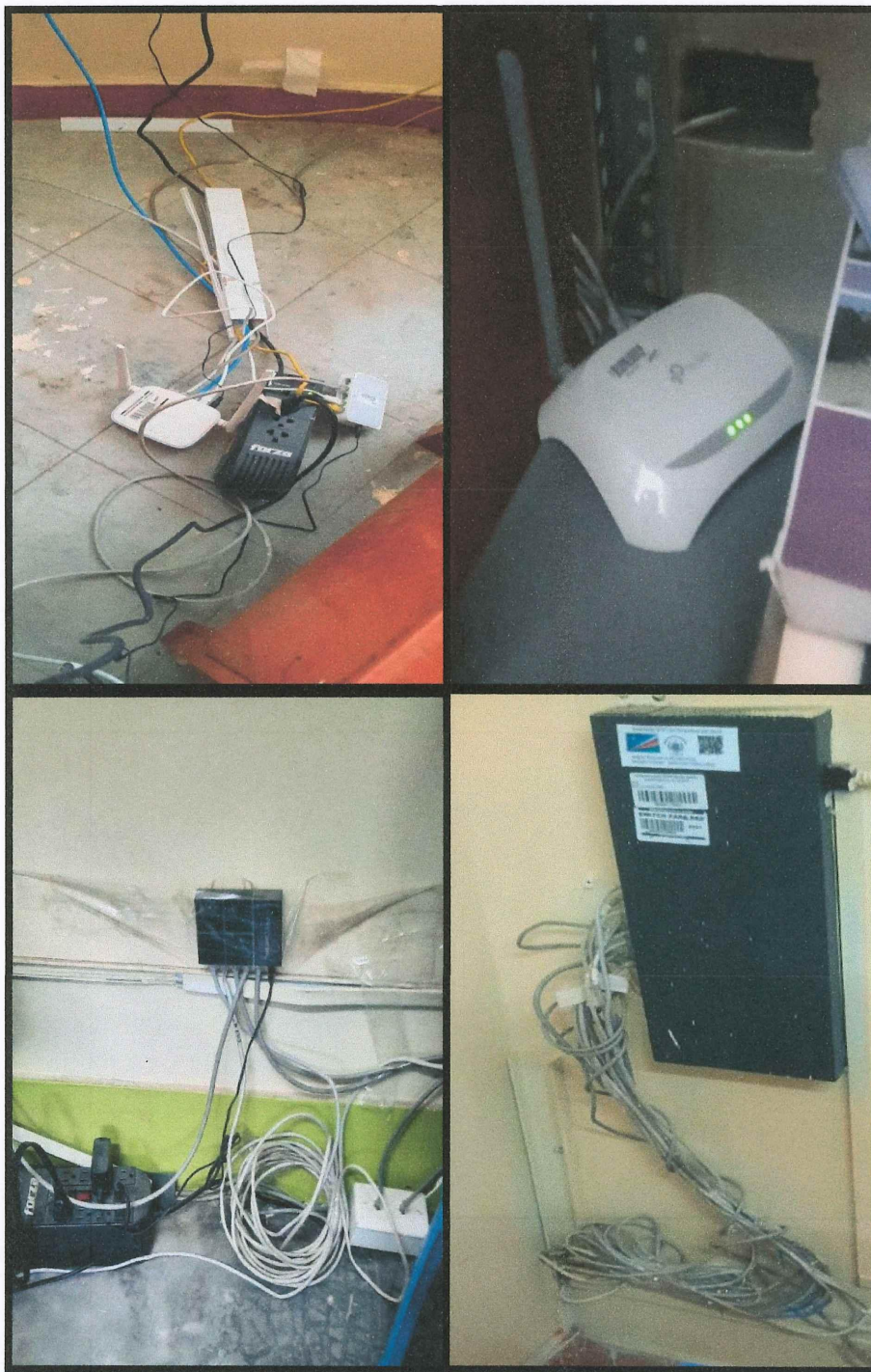
Imagen 15. Estado situacional del cableado y equipos de red
